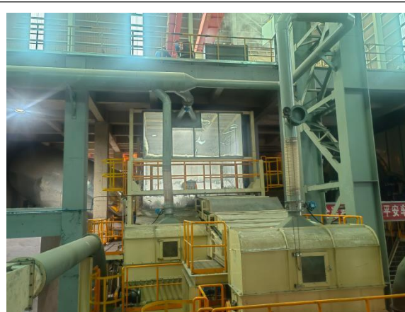
2#矿棉生产线密闭解棉工序+废气管道
