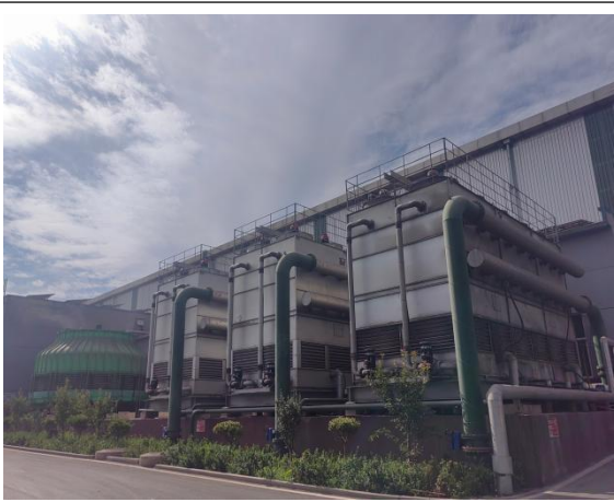
电炉循环冷却设施
