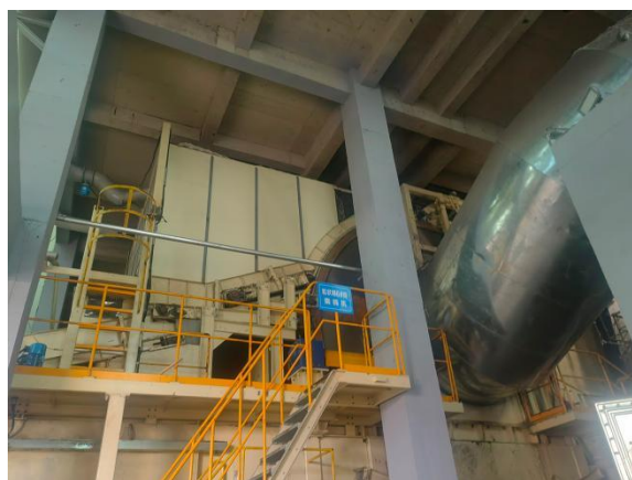
1#矿棉生产线密闭集棉工序+废气管道
