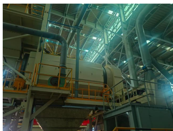
2#矿棉生产线密闭筛分工序+废气管道
