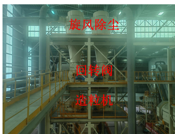
1#矿棉生产线输棉废气
