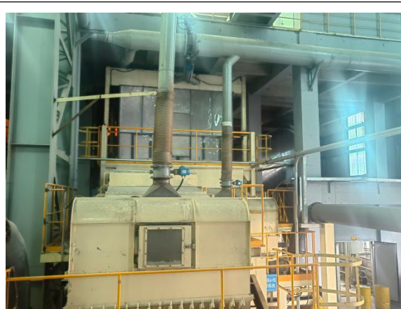
1#矿棉生产线密闭解棉工序+废气管道
